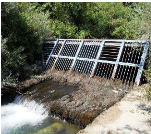
Slika 16 Objekat sistema navodnjavanja - vodozahvat na Lištici
